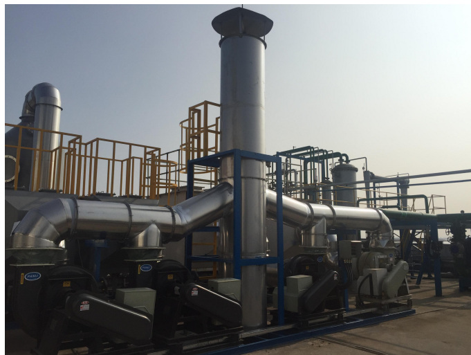
图 4-1 废气处理装置
